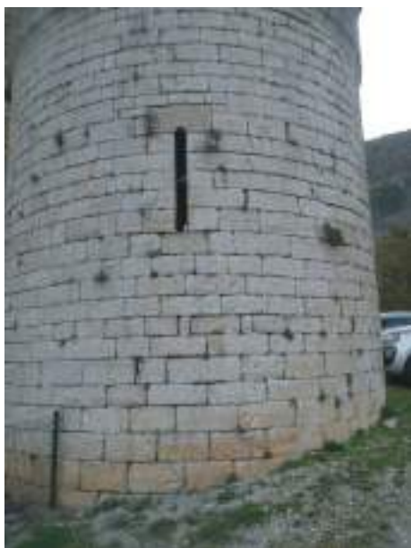
Déjointoiment du parement de moellons équarris du chevet de la chapelle
