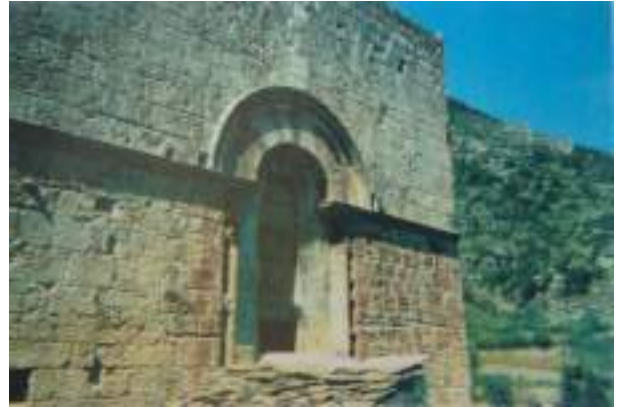
Baie haute, chantier terminé - Dossier Documenté et des Ouvrages Exécutés - Stéphane Thouin, A.C.M.H., Janvier 1995 - Médiathèque de l'Architecture et du Patrimoine
