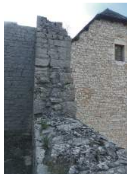
Traitement des arases au ciment et développement de mousses et végétation
