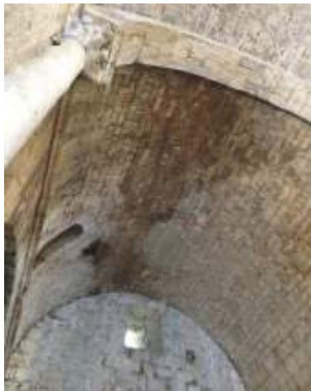
Humidité sur voûtement
