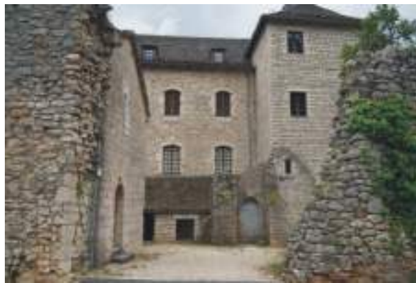
Brèche dans mur d'enceinte ouvrant sur la cour d'entrée
