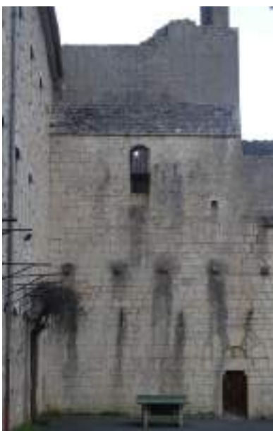
Traces noires au droit des corbeaux
