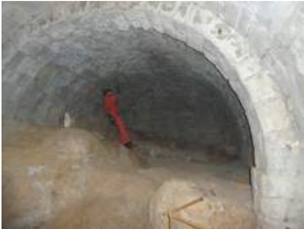
Traces d'humidité sur voûtement de la travée Nord
