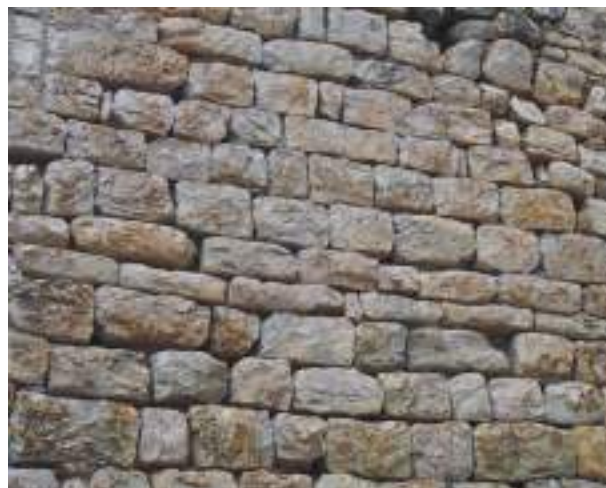
Parements de moellons non équarris déjoints
